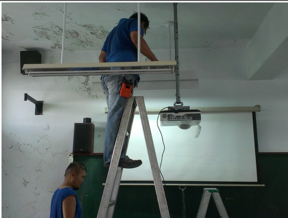
改善教室投影機設備
